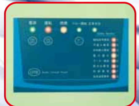
ボイラーコントロールパネル
